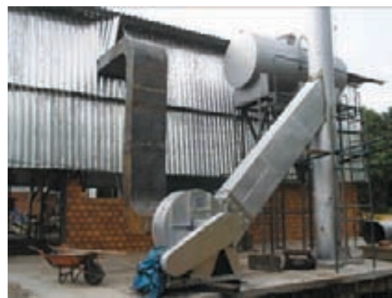
Figura 11.14 – Conjunto de exaustão de gases e tanque de condensado
