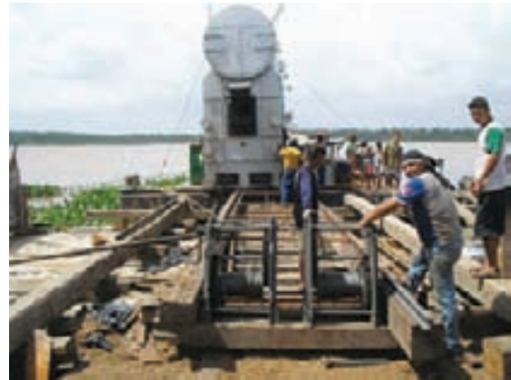
Figura 11.10 – Infra-estrutura utilizada para o transporte da caldeira da balsa até o local de instalação
