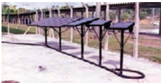
(a) Módulos fotovoltaicos instalados em pequenos postes
