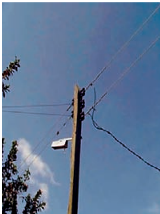
Poste de madeira da rede de distribuição monofásica
