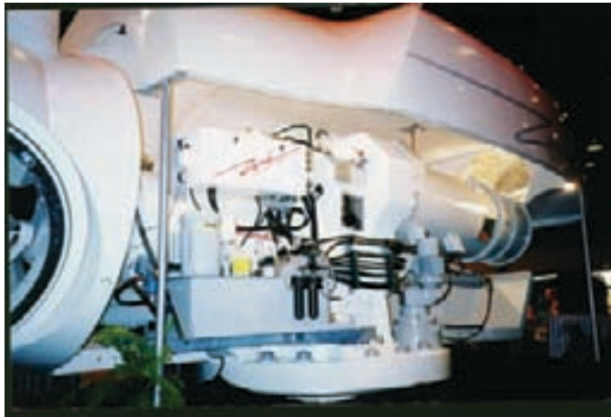
Figura 3.36 – Vista da parte interna da nacele de um aerogerador de grande porte
