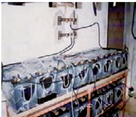
Banco de baterias
