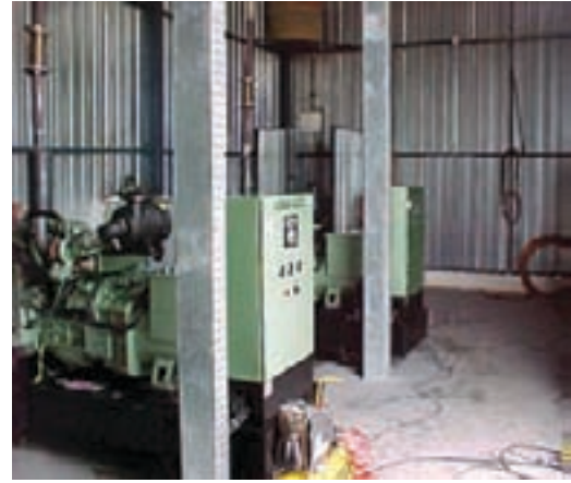
(b) Grupos geradores a diesel
