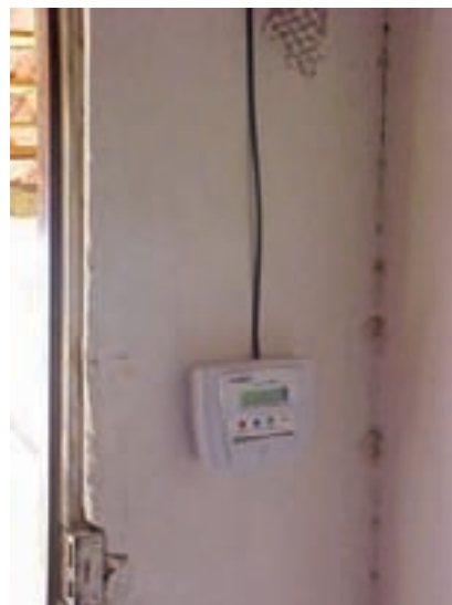
Gerenciador de energia localizado dentro da UC (sistema pré-pago)
