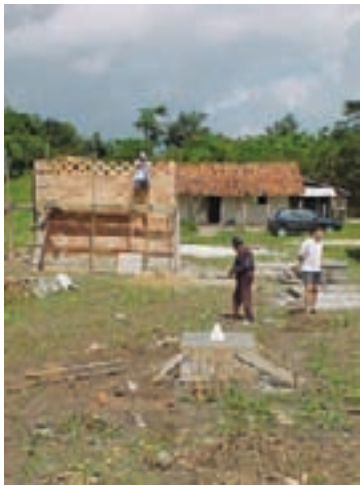
Casa de força, sendo construída e preparação das bases da torre do aerogerador
