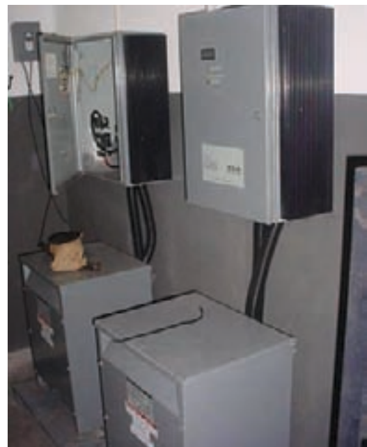
Retificadores fixados na parede e transformadores (abaixo)
