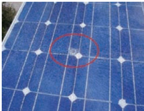
Figura 10.2 – Módulo com o vidro quebrado
