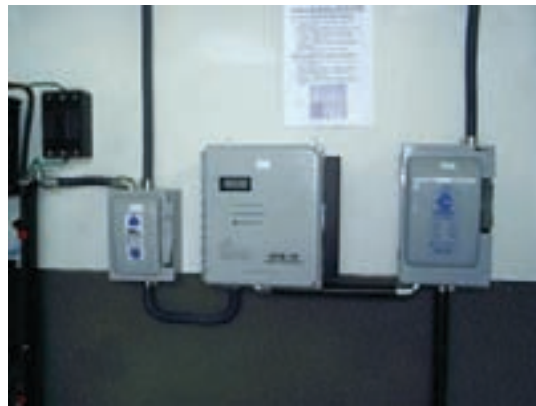
Chaves dos sistemas renováveis nas extremidades e retificador ao centro
