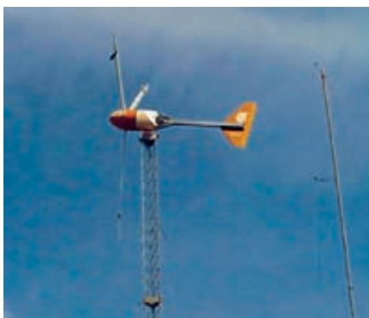
Aerogerador de 7,5 kW e estação meteorológica
