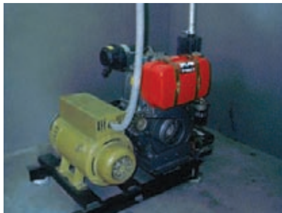
Figura 9.22 – Grupo gerador a diesel de 20 kVA sem sistema de controle
