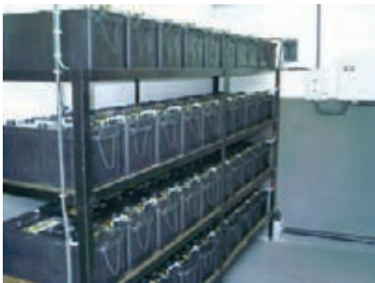
Banco de baterias antigo
