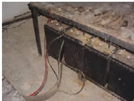
Banco de baterias antigo
