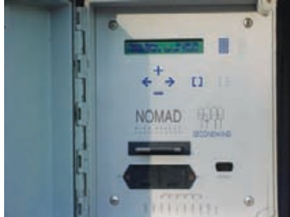
Figura 3.11 – Data-logger para coleta e armazenamento dos dados medidos pelos sensores
