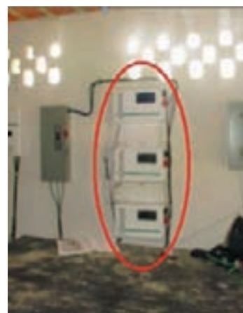
(c) Em destaque, Inversores de tensão monofásicos instalados na parede
