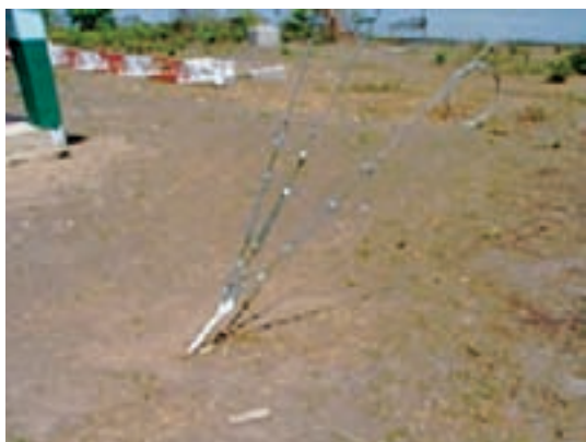
Cabos de sustentação da torre fixados nas âncoras por meio de esticadores
