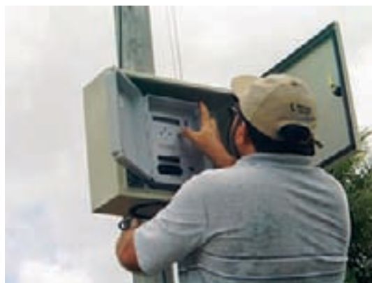
Sistema de aquisição de dados da estação, sendo configurado
