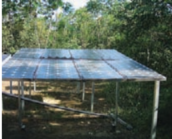
Figura 10.3 – Módulos instalados em região de sombreamento
