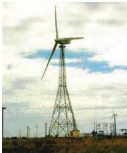
(b) Torre autoportante de aço/aerogerador de grande porte
