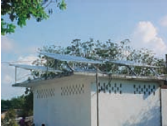
Arranjos fotovoltaicos (antigo e novo) dispostos sobre a casa de força
