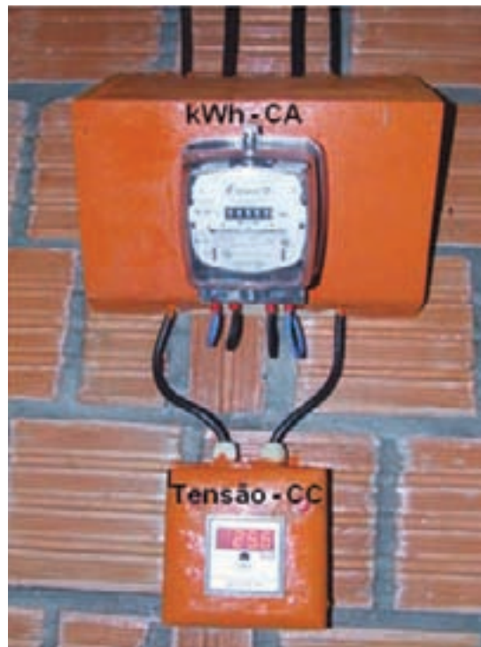
Figura 5.15 – Voltímetro digital usado para medir a tensão do banco de baterias em um sistema autônomo com tensão nominal de 24 V CC
