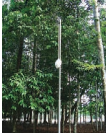
Figura 10.9 – Poste com braço da luminária danificado
