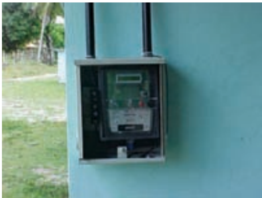
Medidor de energia (sistema pré-pago)
