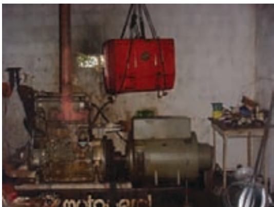
Grupo gerador a diesel antigo em péssimas condições
