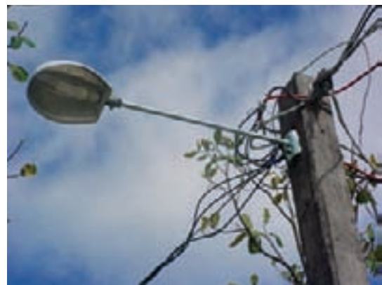
Luminária do sistema de iluminação pública
