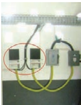
(a) Em destaque, controladores de carga instalados na parede
