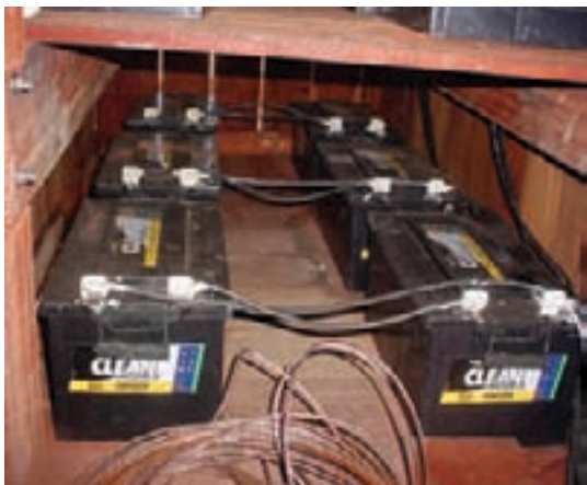
Banco de baterias de um dos arranjos fotovoltaicos existentes
