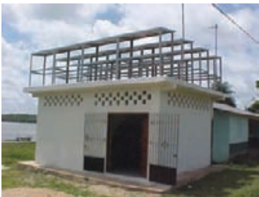
Casa de força e arranjo fotovoltaico sobre a mesma
