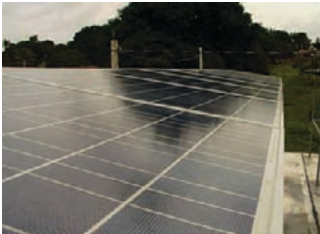
(a) Arranjo fotovoltaico
