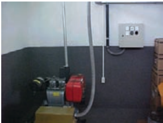
Grupo gerador a diesel e quadro de monitoração
