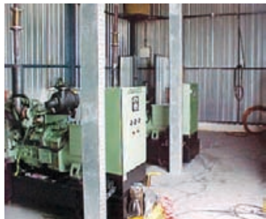
Grupos geradores a diesel
