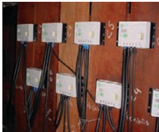
Controladores de carga de um dos arranjos fotovoltaicos existentes
