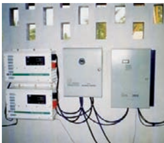
Inversores de tensão à esquerda e retificador à direita
