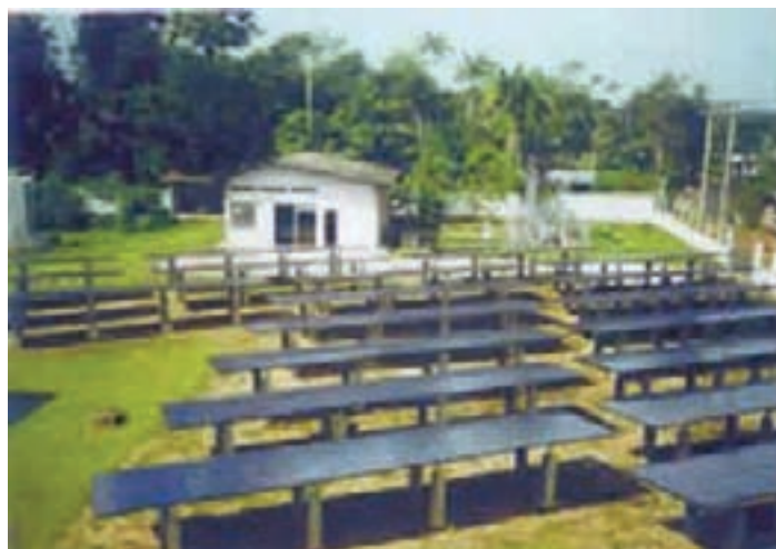
Figura 13.2 – Vista do arranjo fotovoltaico da vila Campinas.
