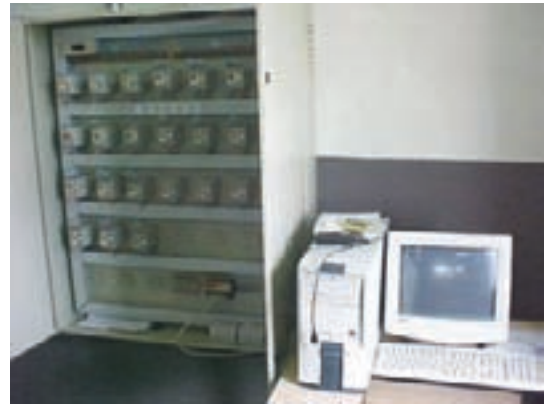
Sistema de monitoração remota
