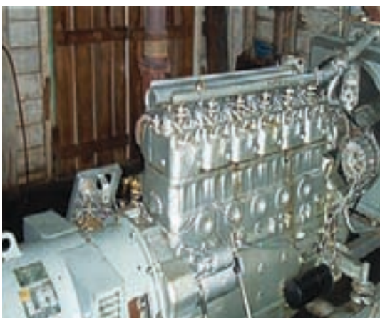
Grupo gerador a diesel existente
