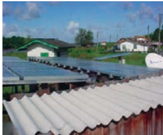
Outro arranjo fotovoltaico, também a ser integrado ao sistema híbrido
