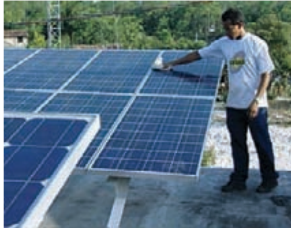
Figura 10.1 – Limpeza dos módulos fotovoltaicos
