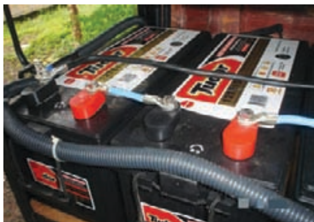
Figura 10.7 – Terminais da bateria e conexão dos cabos
