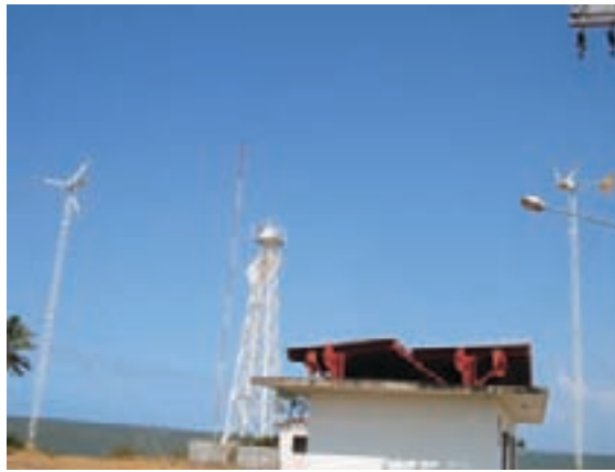
Figura 13.4 – Vista geral do sistema (arranjo fotovoltaico sobre a casa de força)
