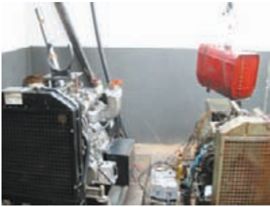
Grupo gerador diesel novo ao lado do velho
