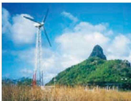
(a) Aerogerador 75 kW
