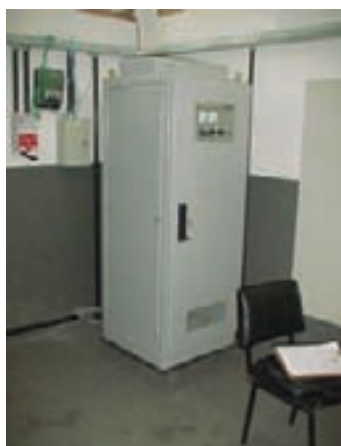
(b) Inversor de tensão trifásico instalado em local específico
