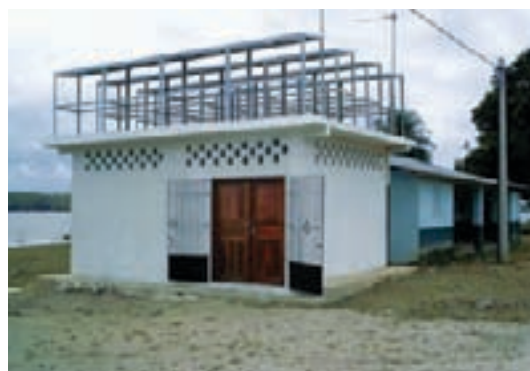
(d) Módulos fotovoltaicos instalados sobre laje da edificação através de estrutura metálica
